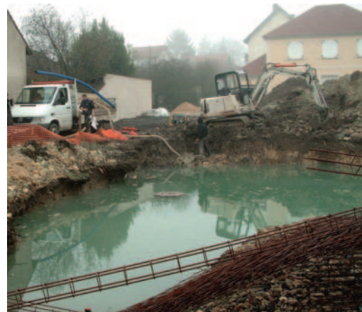
Inondation lors de travaux faits sans précautions
